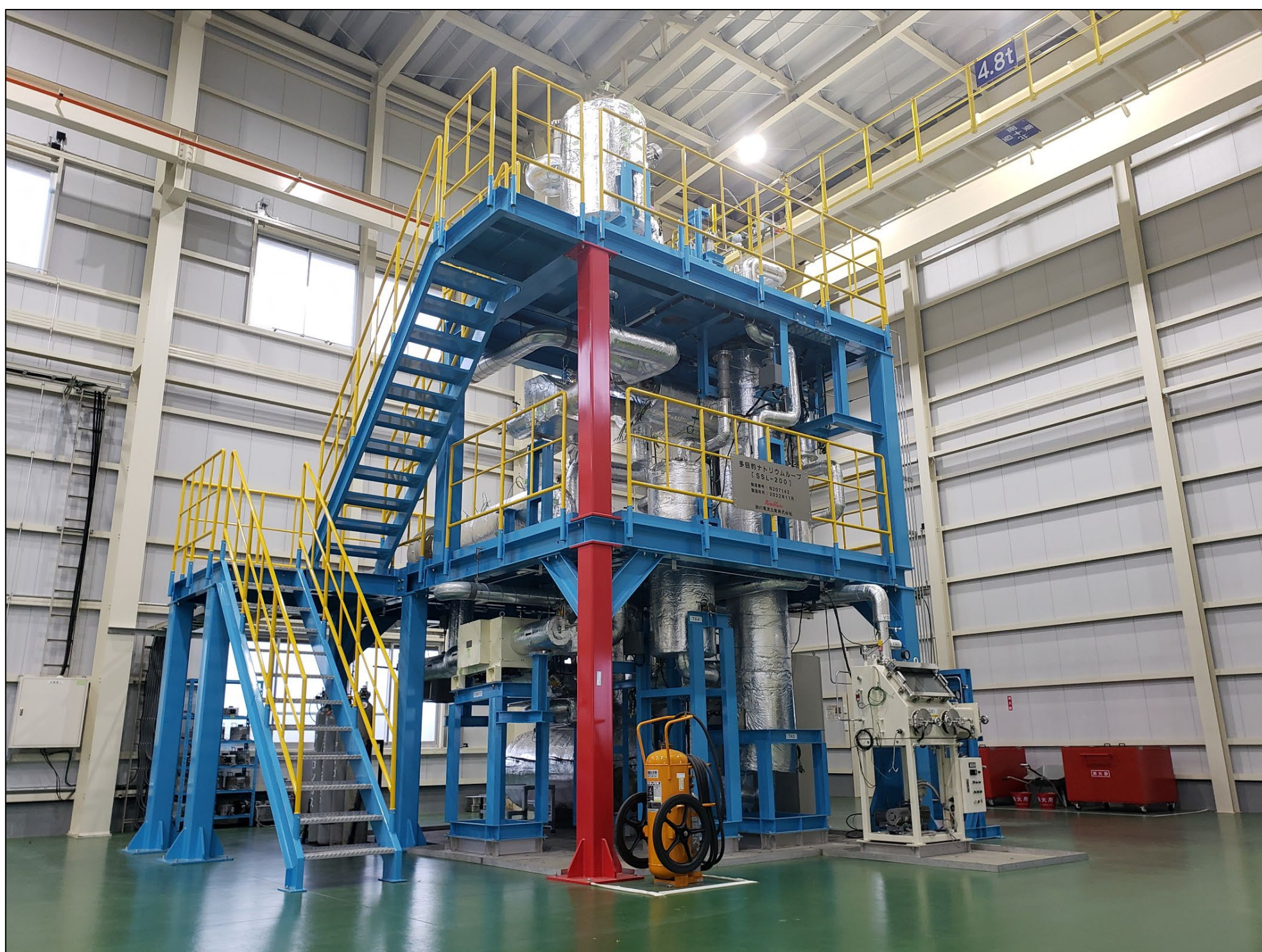
SSL-200 (Sukegawa Sodium Loop-200)
